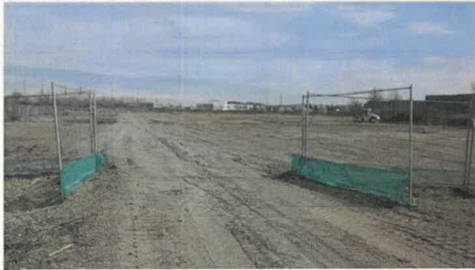
Figure 32 : Exemple de barrière amovible sur les accès chantier
